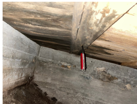
Bjelker og stubbloft med råteskader.
