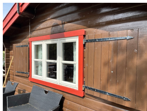
Manglende vannbrett beslag på vindu.
