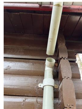
Bilde viser lafteknuter som ikke er tette.
