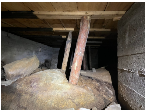
Krypkjeller med provisorisk understøttelse.
