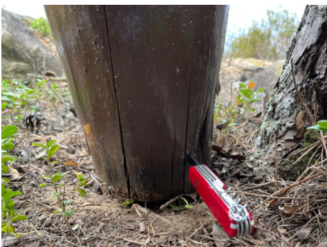
Råte i tre-søyler.
