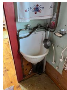
Vannrør av kobber til utslagsvask.
