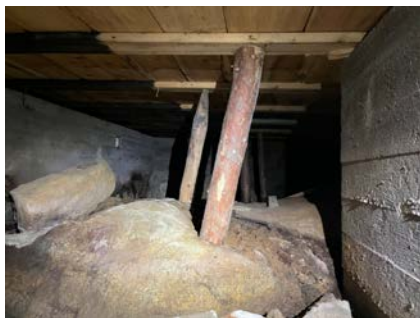
Krypkjeller med provisorisk understøttelse.
