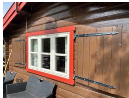
Manglende vannbrett beslag på vindu.
