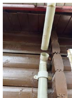
Bilde viser lafteknuter som ikke er tette.
