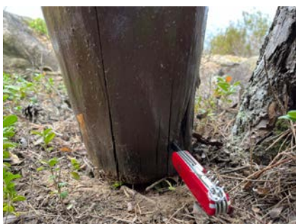
Råte i tre-søyler.
