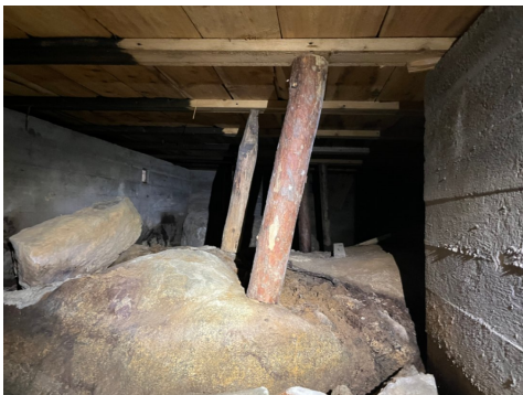
Kryptkjeller med provisorisk understøttelse.
