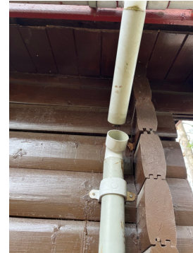
Bilde viser lafteknuter som ikke er tette.
