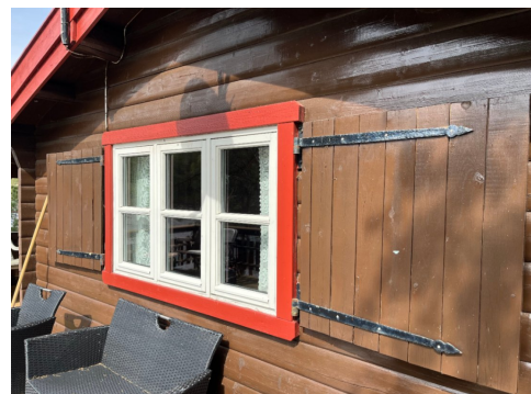
Manglende vannbrett beslag på vindu.
