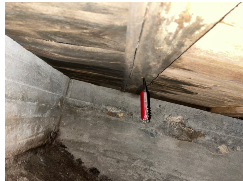
Bjelker og stubbloft med råteskader.
