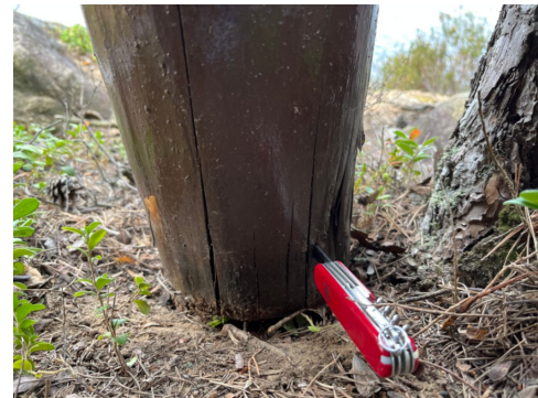
Råte i tre-søyler.
