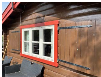
Manglende vannbrett beslag på vindu.
