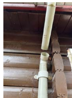
Bilde viser lafteknuter som ikke er tette.
