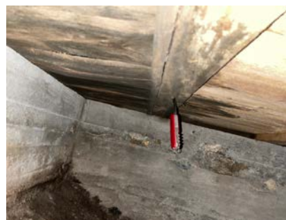
Bjelker og stubbloft med råteskader.
