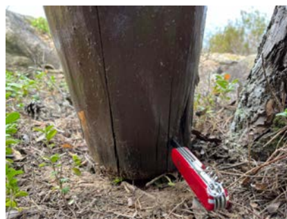
Råte i tre-søyler.
