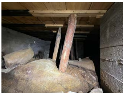
Krypkjeller med provisorisk understøttelse.
