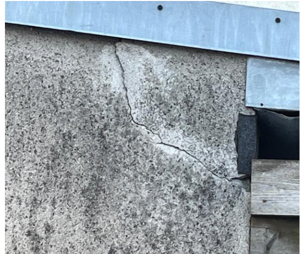
Figur 12: Oppsprukket betong/ pusslag mot skolegata.
