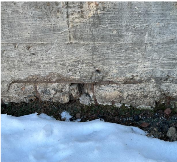
Figur 5: Betongskader på fasade.
