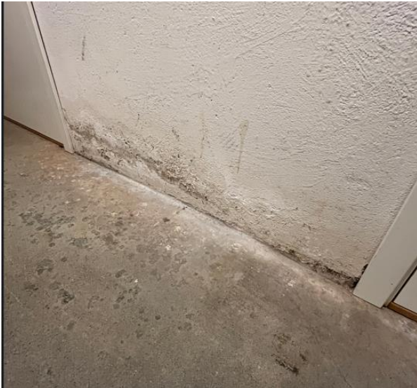
Figur 3: Saltutslag/avskalling underkant vegg.
