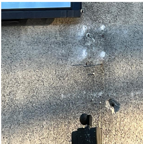
Figur 7: Puss-skade mot Kongens gate
