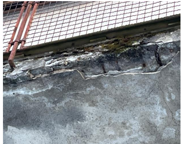
Figur 6: Armeringskorrosjon under veranda
