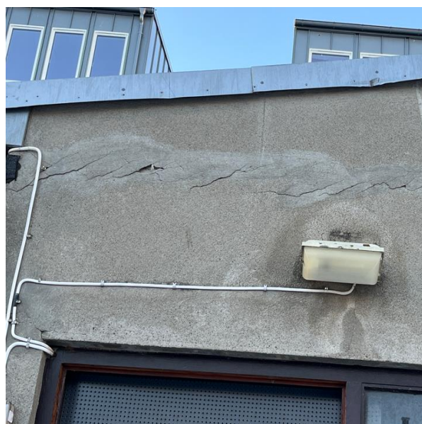
Figur 8 Oppsprekking mot skolegata
