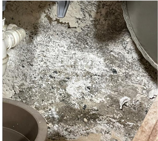
Figur 4: Kjellervegg med saltutslag..
