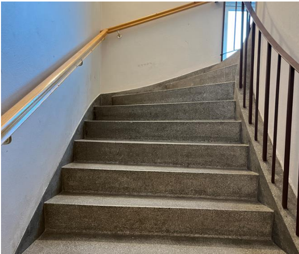
Figur 19: Hovedtrapp innvendig, generell tilstand.
