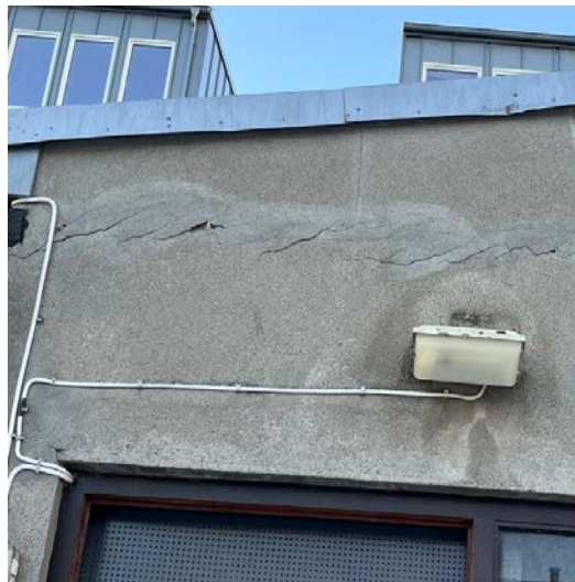
Figur 8 Oppsprekking mot skolegata
