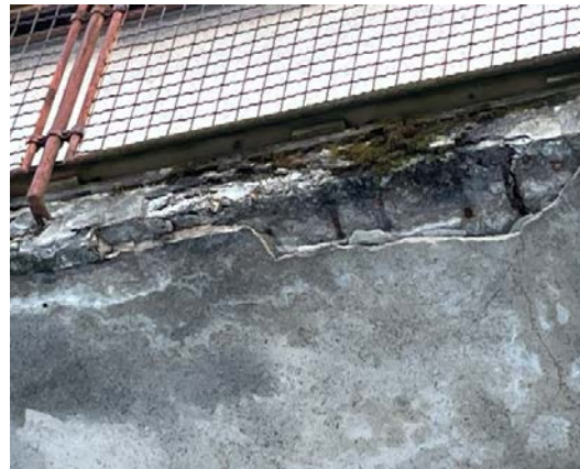
Figur 6: Armeringskorrosjon under veranda
