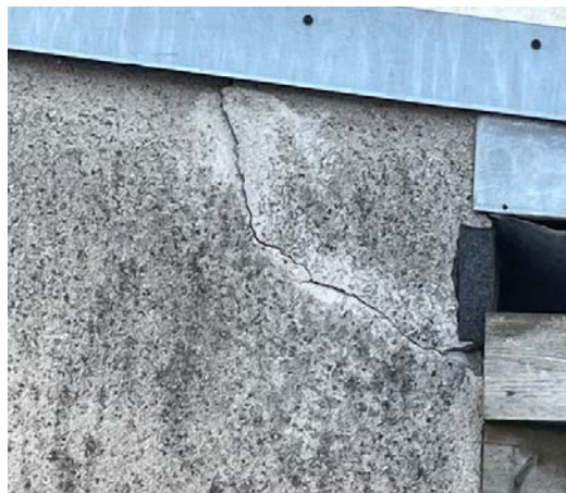
Figur 12: Oppsprukket betong/ pusslag mot skolegata.
