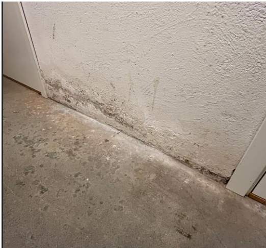
Figur 3: Saltutslag/avskalling underkant vegg.
