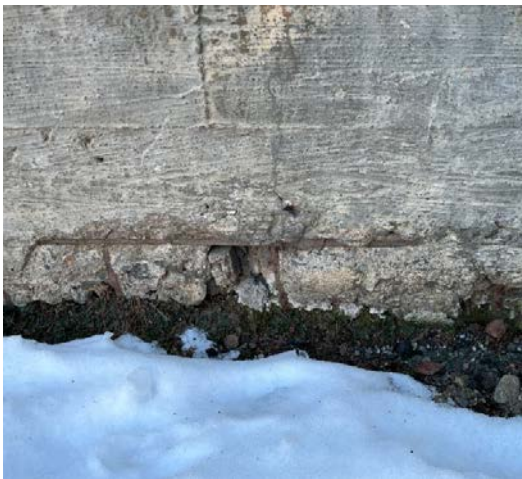
Figur 5: Betongskader på fasade.
