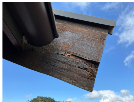
Råteskader i vindskier.
