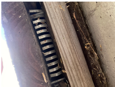
Museband montert, ingen garanti for at det er tett for gnagere.
