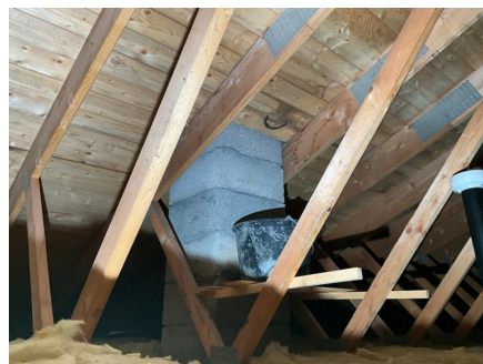
Fuktmerker rundt pipe.
