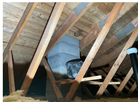
Fuktmerker rundt pipe.
