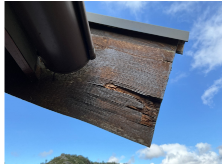
Råteskader i vindskier.
