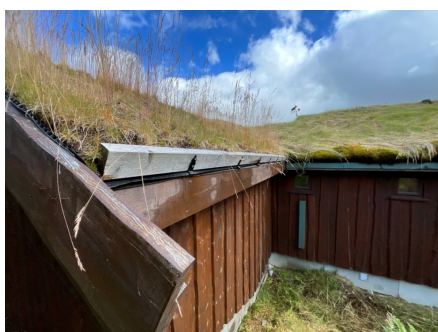
Mangler takrenne og beslag.
