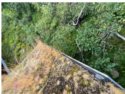
Ikke montert beslag, fare for vann inn på undertaket.
