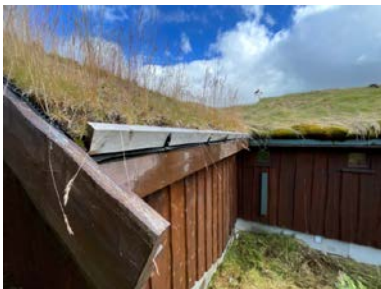
Mangler takrenne og beslag.
