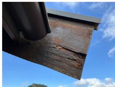
Råteskader i vindskier.
