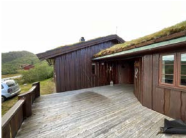
Kledning som står nærme terrenget vil ha økt behov for maling og med fare for fukt og råte i kledningen og bakenforliggende konstruksjoner.
