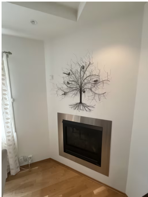
Viser gasspeis montert i stue. Gassvarsler montert.
