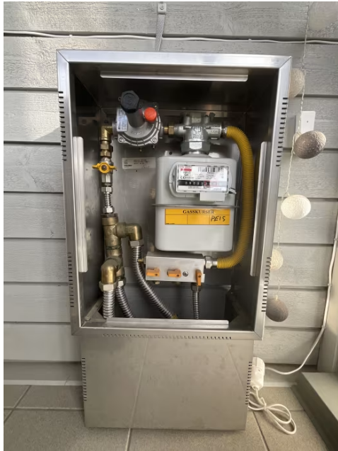
Viser utvendig målerskap for gasspeis.
