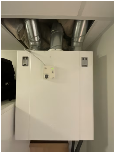
Viser aggregat plassert på teknisk rom. Ingen feilmelding på display.
