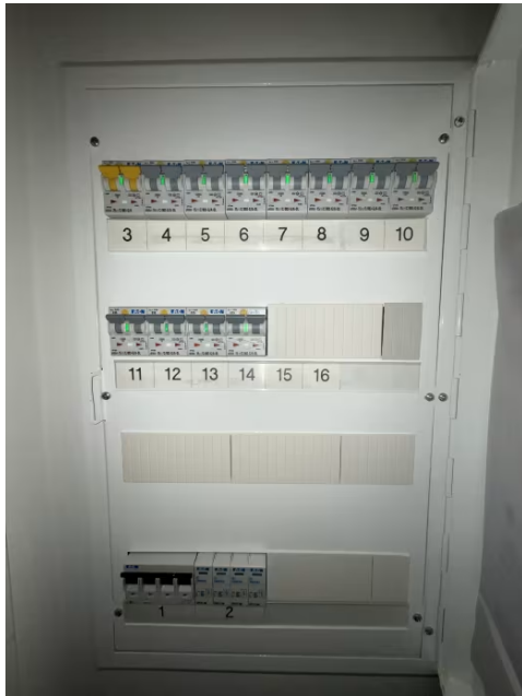
Viser sikringsskap plassert på teknisk rom.
