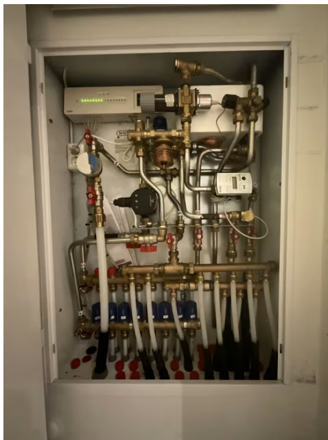
Viser fordelerskap plassert på teknisk rom.
