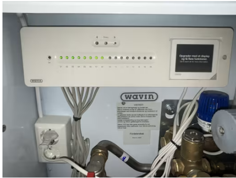
Viser styringspanel for gulvvarme.
