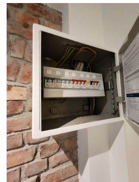
Automatsikringer i sikringsskap.
