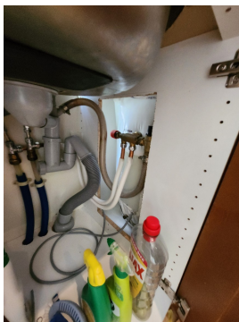
Bereder plassert i benkeskap på kjøkken.
