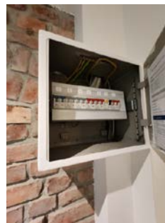
Automatsikringer i sikringskap.
