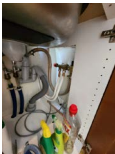
Bereder plassert i benkeskap på kjøkken.
