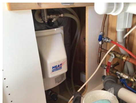
Varmtvannstank i kjøkken benk.
