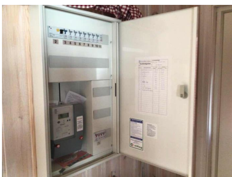
Sikringsskap i gang.
