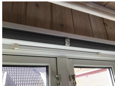
Ventil i vinduer.
