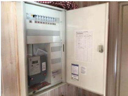
Sikringsskap i gang.
