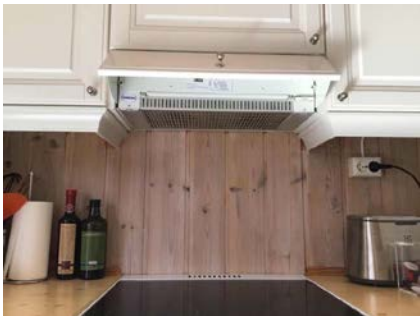
Avtrekk over komfyr.
