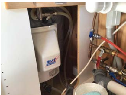
Varmtvannstank i kjøkken benk.
