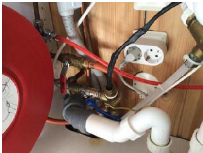
Stoppekran i kjøkkenbenk.
