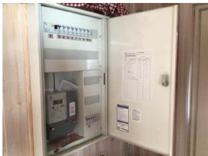
Sikringsskap i gang.
