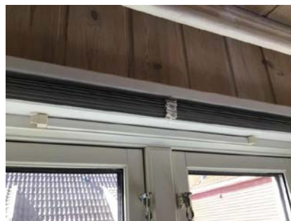
Ventil i vinduer.
