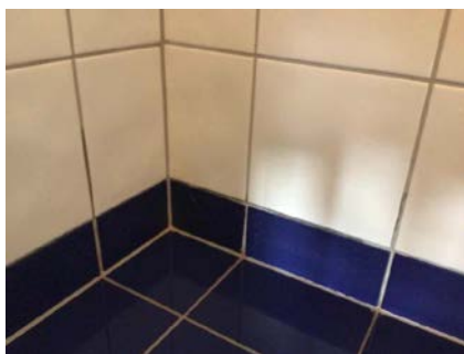
Flis på vegg med sprekke.
