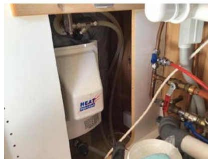
Varmtvannstank i kjøkken benk.
