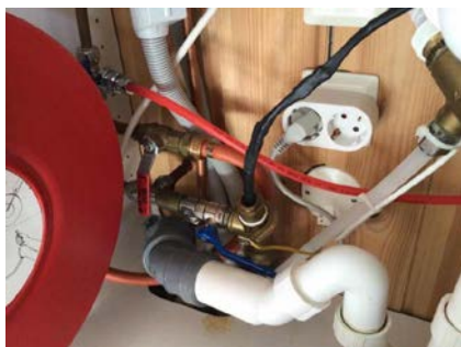
Stoppekran i kjøkkenbenk.
