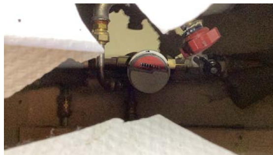
stoppekran i entre.
