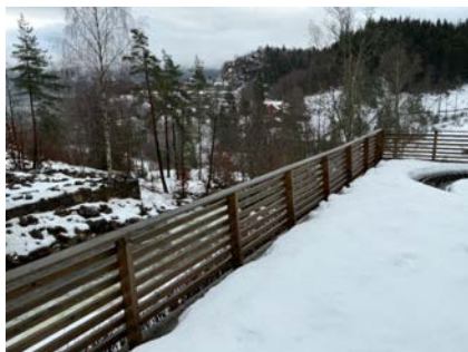
Ikke ønskelig med slike spiler fordi de gir klatrefare for barn.
