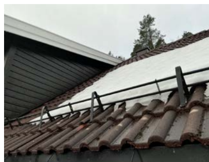
Snøfangere mot terrasse.
