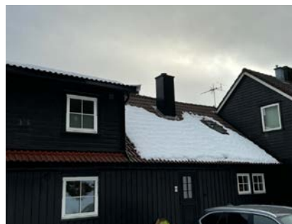
Ikke snøfangere mot inngang.
