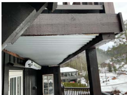
Plater under, medfører drypp ned ved stolpe.
