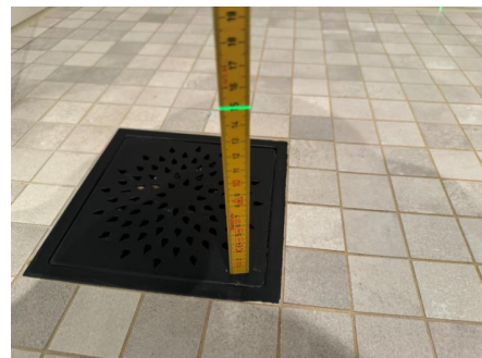
Fallforhold ca. 150 mm topp slukrist i dusjsone
