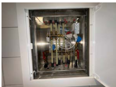
Vannfordelerskap rør-i-rør system, waterguard og stoppekran
