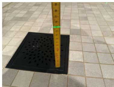
Fallforhold ca. 150 mm topp slukrist i dusjsone
