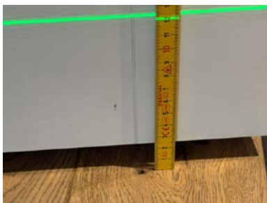
Gulv i hovedsoverom har en høydeforskjell på ca. 35 mm (målt ca. 120 mm fra gulv)
