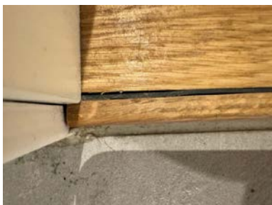
Synlig membran oppbrett ved terskel
