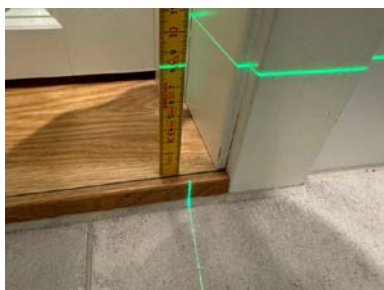
Fallforhold ca. 82 mm topp oppbrett membran ved terskel
