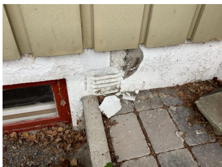
Skader på grunnmur.
