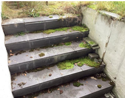
Trapp bærer preg av slitasje og manglende vedlikehold.
