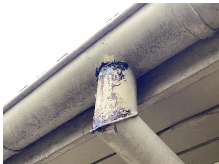
Lekkasje registrert i overgang til nedløp.
