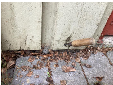
Råte i nedre del av kledning.
