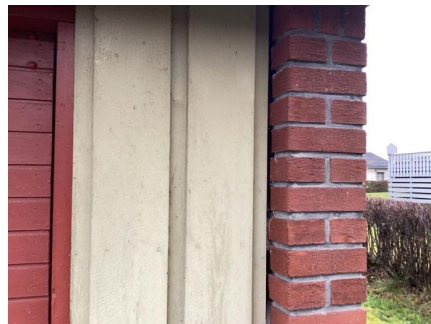
Glippe mellom mur og trevegg inn til garasje.
