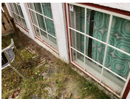
Lav høyde mellom terreng og kjellervinduer.
