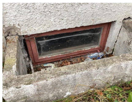
Utvendig tetting mangler rundt enkelte av vinduene.
