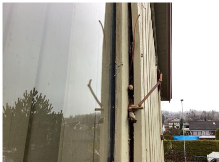
Greiner har vokst inn bak kledningen og presser utover.
