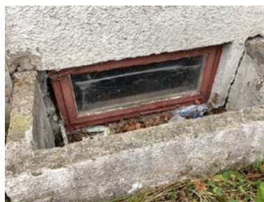
Utvendig tetting mangler rundt enkelte av vinduene.
