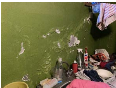
Det er påvist indikasjoner på fuktgjennomtrenging inn i kjellervegg.
