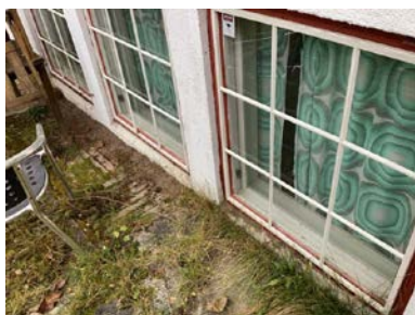
Lav høyde mellom terreng og kjellervinduer.
