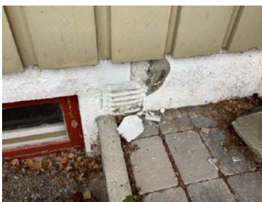
Skader på grunnmur.
