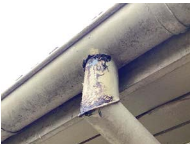
Lekkasje registrert i overgang til nedløp.
