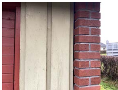
Glippe mellom mur og trevegg inn til garasje.
