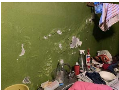
Det er påvist indikasjoner på fuktgjennomtrenging inn i kjellervegg.
