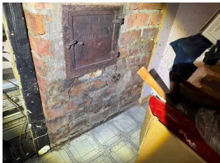
Ikke ildfast plate under sotluken.
