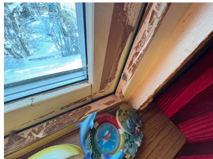
Eksempel på utett vindu.
