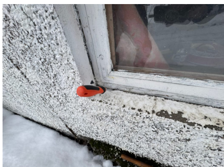
Eksempel på avvik rundt innsetningsdetaljer.
