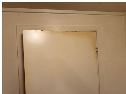
Eksempel på skade på dør.
