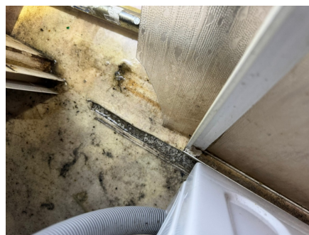
Skade i vinylbelegget.
