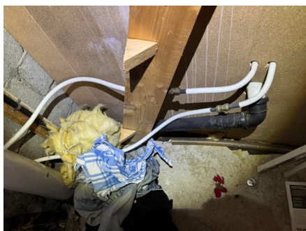
Vannrør er ikke klamret.
