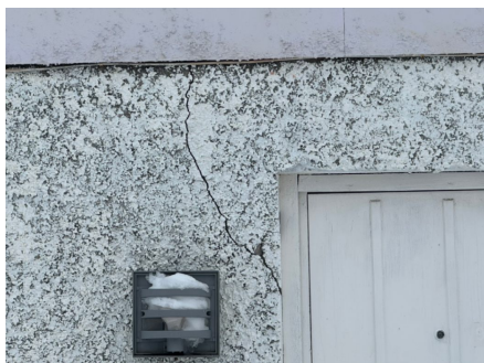
Eksempel på sprekk i grunnmuren.
