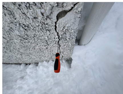
Eksempel på sprekk i grunnmuren.
