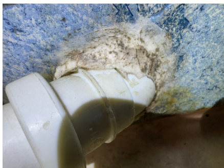
Utettheter og tegn til fuktskade.
