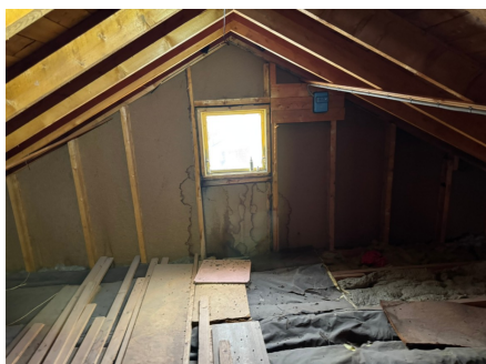
Fuktskjolder ved vindu på loftet.
