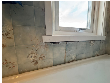
Tegn til fuktskader under vinduet.
