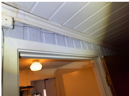
Eksempel på løs ledning.
