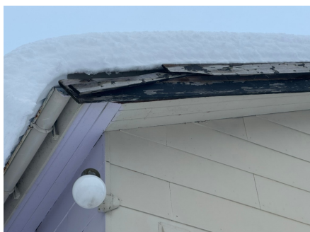
Skader på vindskibord.
