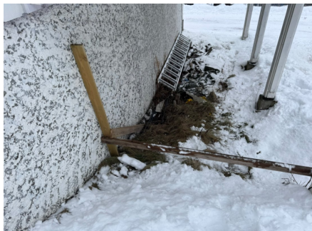
Ikke utvendig fuktsikring.
