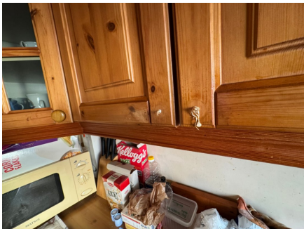
Eksempel på manglende håndtak.
