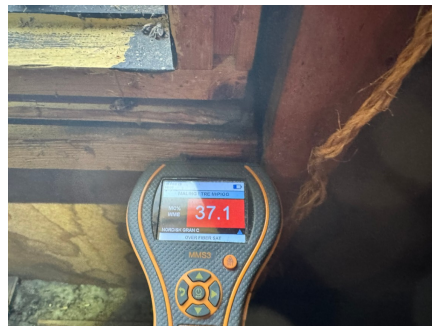
Fuktmåling under vinduet på loftet.
