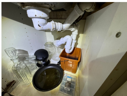
Lekkasje på avløpsrør.
