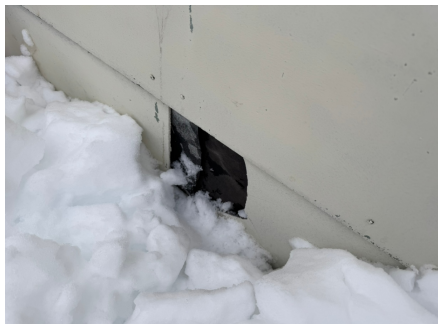
Eksempel på skadet eternittplate.
