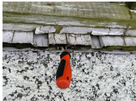
Eksempel på råteskadet kledning.
