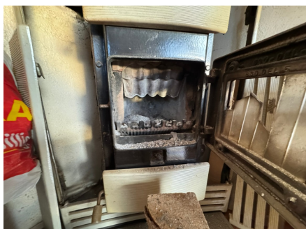
Skadet ildfast stein i ovnen.
