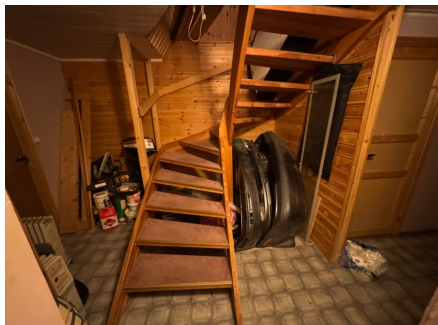
Manglende rekkverk på trappen.
