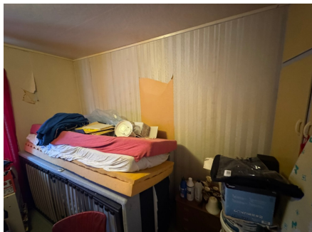
Eksempel på skader på overflatene.
