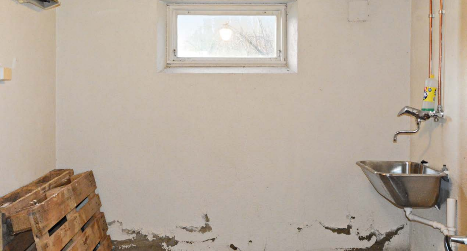
Vaskerom i kjeller
