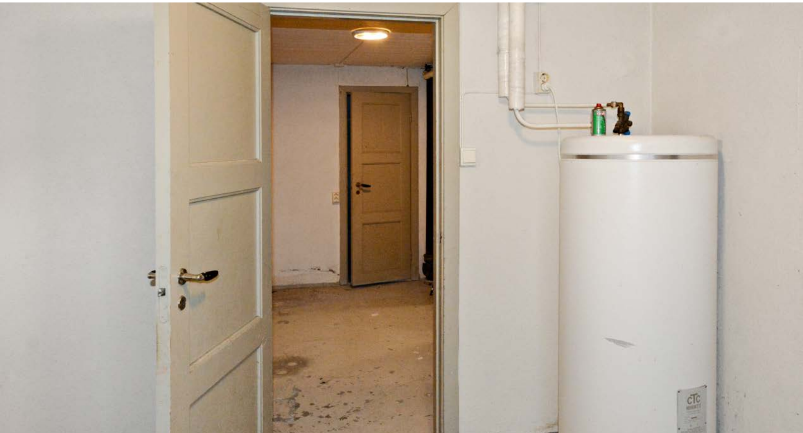
I vaskerommet står også varmtvannstanken
