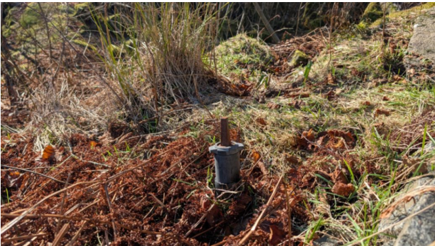
Utvendige stoppekran plassert bakside bod.
