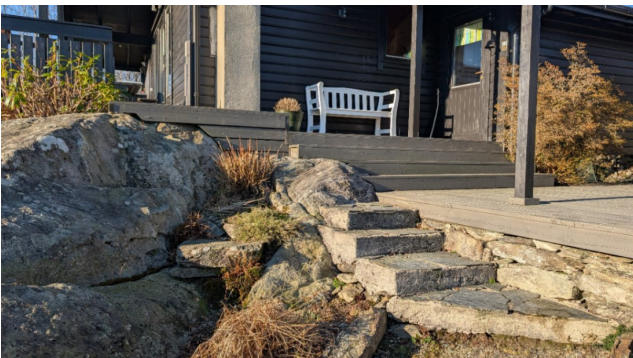
Det er spesielt i forkant av boligen det må vurderes behov for sikring for å unngå fallskader.
