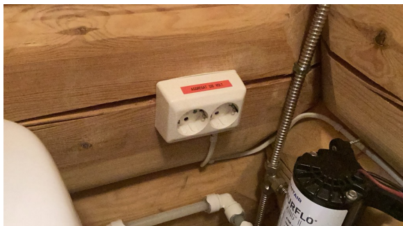
230 V stikkontakt på bad.
