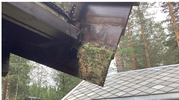
Eksempel på slitasje på vindski
