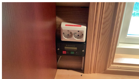
230 V stikkontakt og bryter for aggregat på kjøkken.
