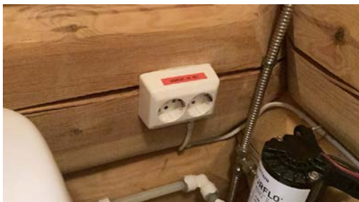
230 V stikkontakt på bad.
