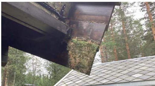
Eksempel på slitasje på vindski
