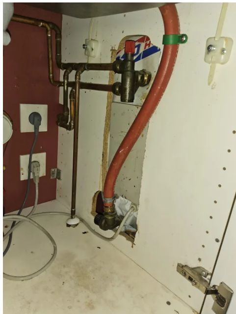
Bilde viser varmtvannsbereder.
