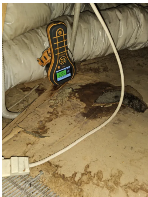
Bilde viser fuktmåling på kaldtloft.
