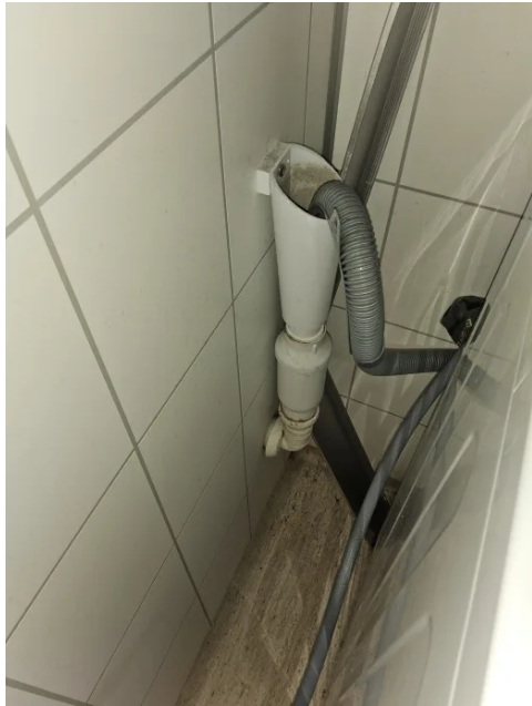
Bilde viser avløpsrør til vaskemaskin.
