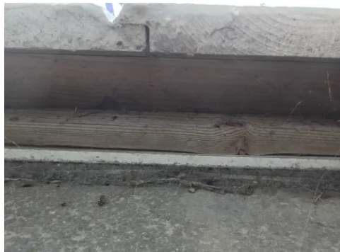
Bilde viser manglende lufting av kledningen.
