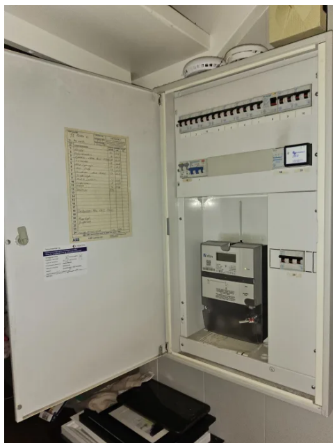
Bilde viser sikringsskap.
