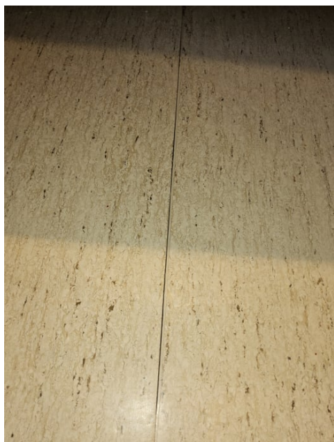
Bilde viser sprekk i gulvbelegg.
