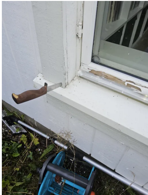
Bilde viser råteskade i omramming.
