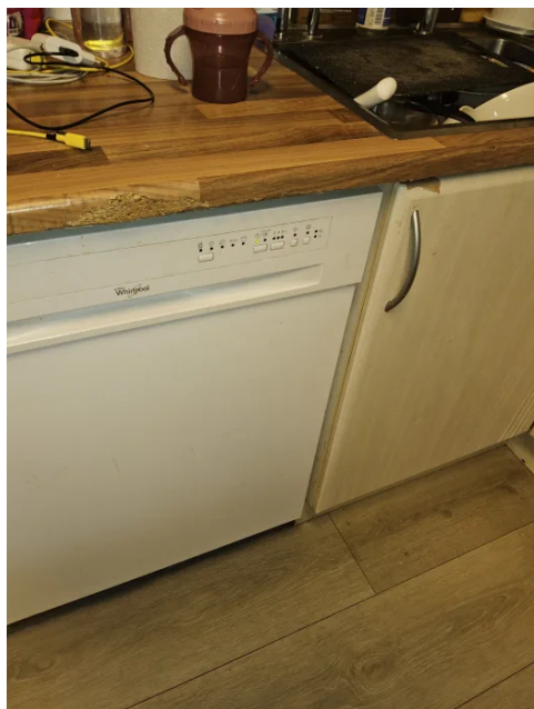
Bilde viser skader på kjøkkeninnredningen.
