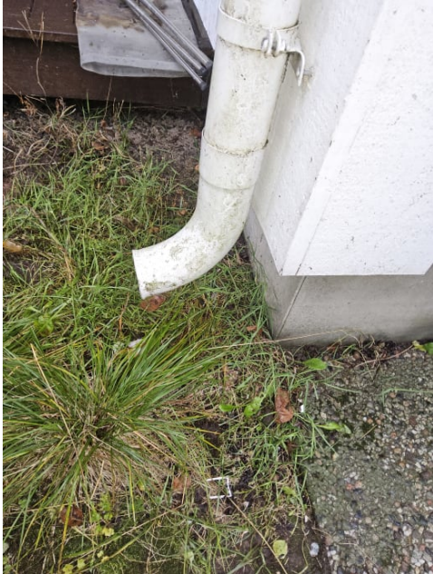
Bilde viser taknedløp avsluttet over bakken.
