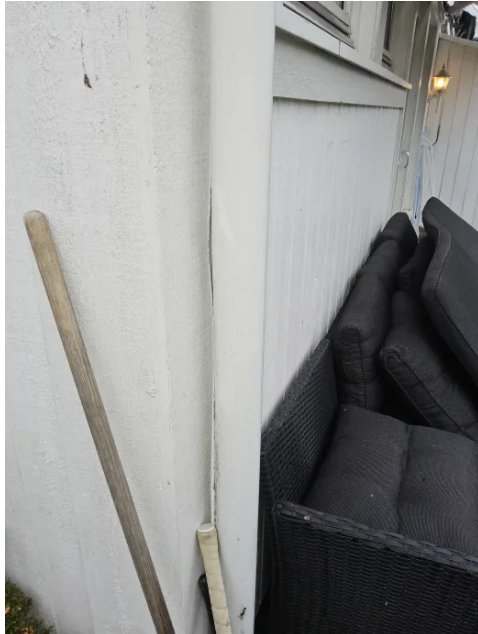
Bilde viser frostsprengt nedløpsrør.
