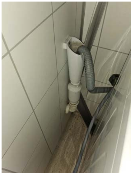
Bilde viser avløpsrør til vaskemaskin.
