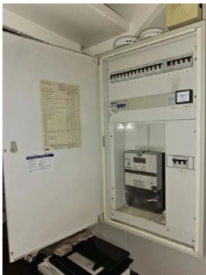
Bilde viser sikringsskap.
