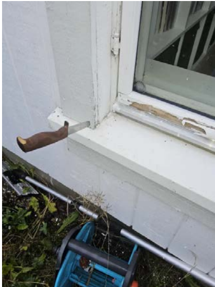
Bilde viser råteskade i omramming.
