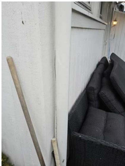
Bilde viser frostsprengt nedløpsrør.
