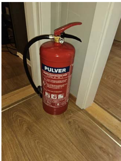
Bilde viser brannslukningsapparat.
