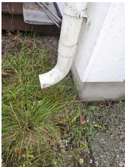
Bilde viser taknedløp avsluttet over bakken.
