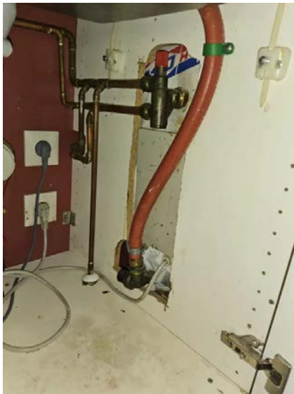
Bilde viser varmtvannsbereder.
