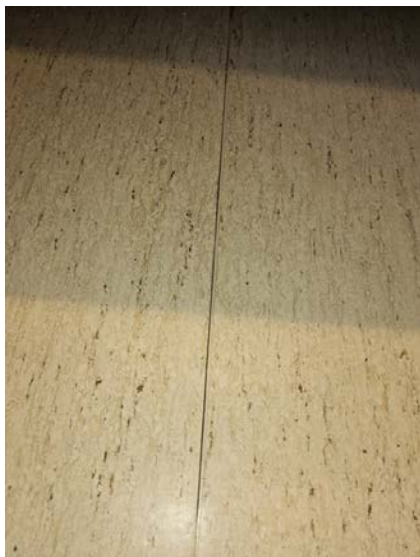
Bilde viser sprekk i gulvbelegg.
