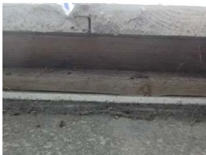
Bilde viser manglende lufting av kledningen.
