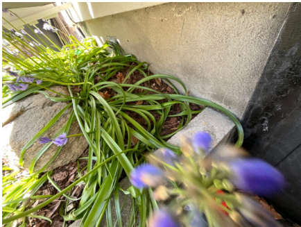
Ingen synlig fuktsikring.
