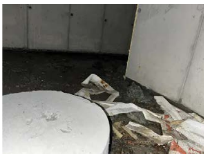
Synlig fukt/ stående vann på gulv i kryprom under bod.
