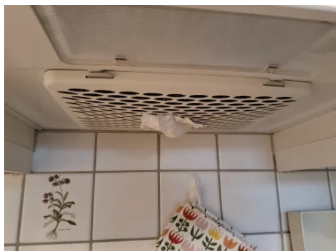
Avtrekkseffekt er testet med papir.
