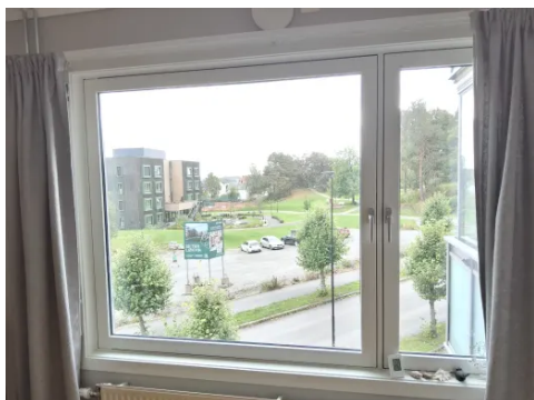
Vindu på stue har behov for justering.
