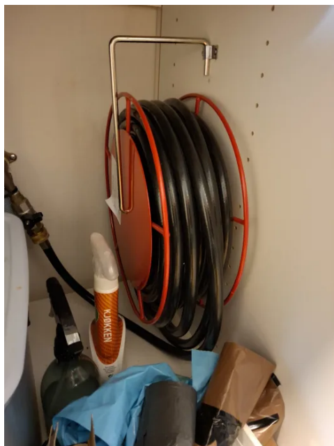
Husbrannslange er plassert i kjøkkenskap,
