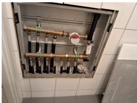
Fordelerskap er plassert på toalettrom.
