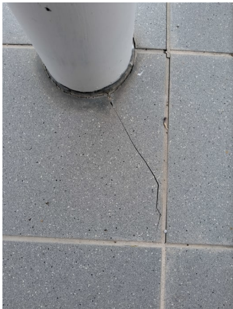
Det registreres gulvfliser med sprekker ved søyer.
