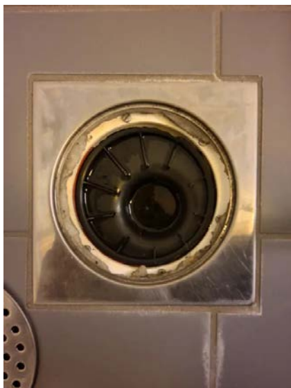
Det ble ikke registrert tegn til avvik i overgang membran/sluk.
