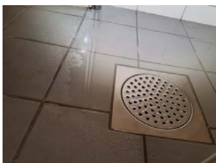
Vannsamling (lite fall) ved sluk.
