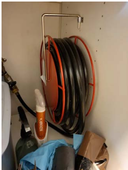
Husbrannslange er plassert i kjøkkenskap,
