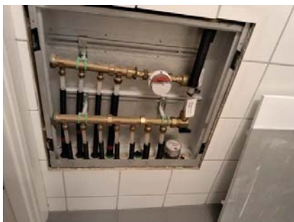
Fordelerskap er plassert på toalettrom.
