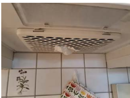
Avtrekkseffekt er testet med papir.
