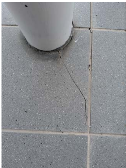
Det registreres gulvfliser med sprekker ved søyler.
