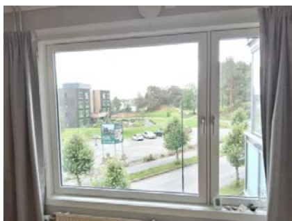
Vindu på stue har behov for justering.
