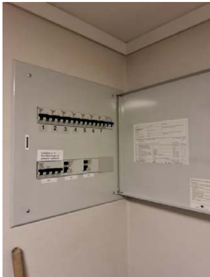
Sikringsskap er plassert i bod.
