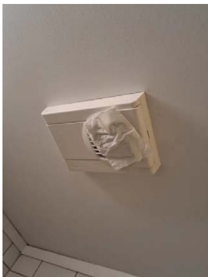
Avtrekkseffekt er testet med papir.
