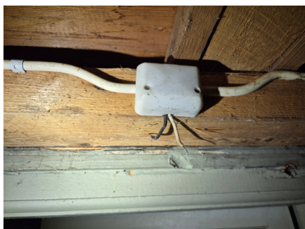
Løse ledere som stikker ut av koblingsboks
