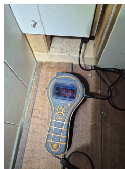
Målt høye fuktverdier i bunnsvill.
