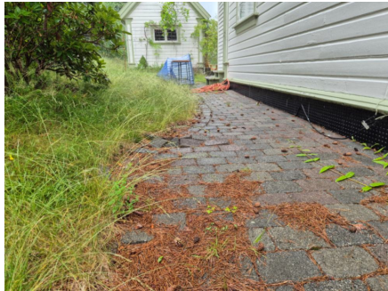
Ikke tilstrekkelig med fall 3 meter vekk fra boligen.
