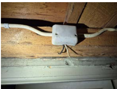
Løse ledere som stikker ut av koblingsboks
