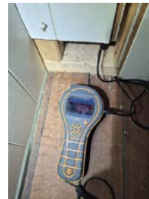
Målt høye fuktverdier i bunnsvill.
