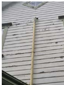
Kledningsbord mot vest bærer preg av slitasje.
