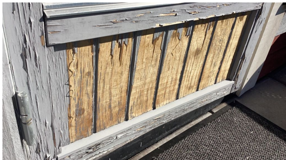
Slitasje på tidspunkt for befaring.
