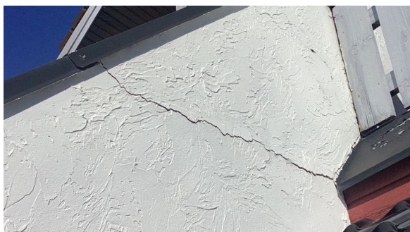
Eksempel på sprekk i murvegg
