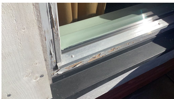
Eksempel på slitasje.
