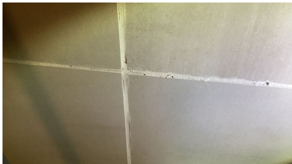
Sprekker i fuger på vegg over toalett.
