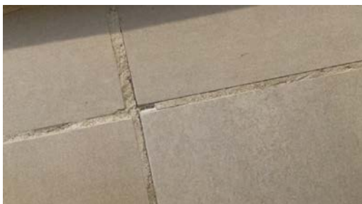
Fuge begynner å sprekke opp ved dør.
