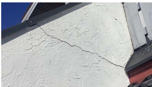
Eksempel på sprekk i murvegg
