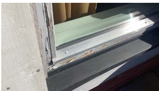
Eksempel på slitasje.
