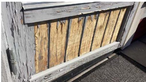
Slitasje på tidspunkt for befaring.
