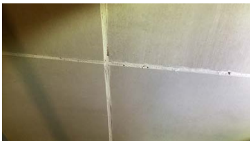
Sprekker i fuger på vegg over toalett.
