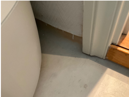
Løs tapet i bunnen av veggen.
