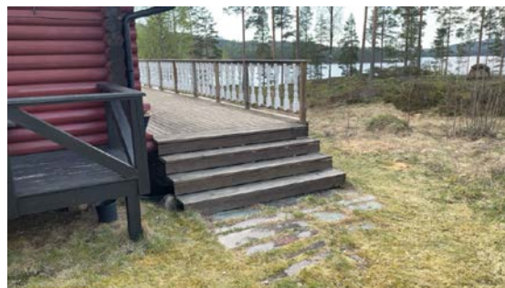
Verandarekkverk med høyde på ca. 93 cm. Åpninger i rekkverk over 10 cm. Trapp uten rekkverk.
