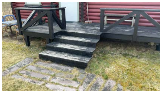
Rekkverk under 90 cm. Åpninger i rekkverk over 10 cm. Trapp uten rekkverk.
