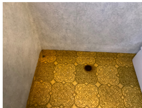
Svimerke på gulvbelegg
