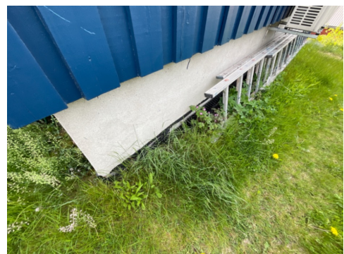
Skadet knotteplast (Platon) på grunnmure
