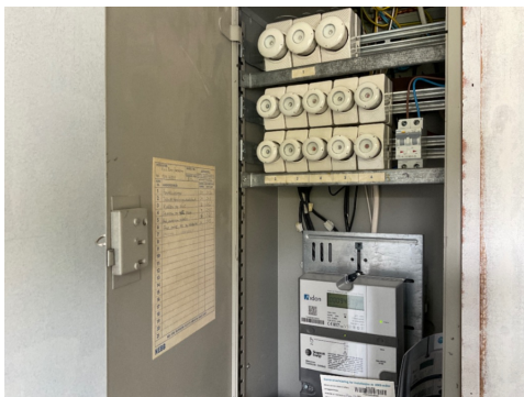
Sikringsskap på soverom 1. etasje
