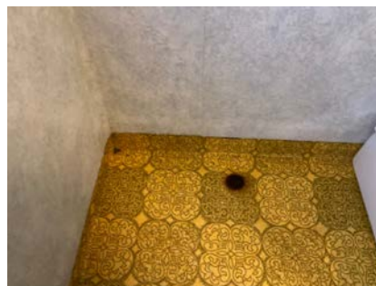
Svimerke på gulvbelegg
