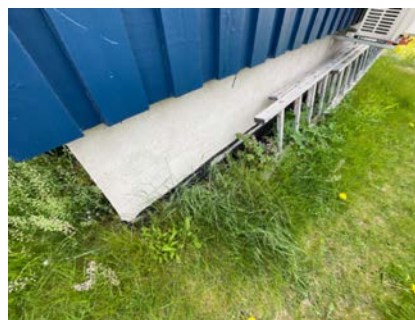
Skadet knotteplast (Platon) på grunnmure
