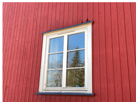
Råteskade i kledning over vindu. anbefaler ytterligere undersøkelser.
