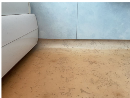
Manglende fuge/dekkelist i bunn av plater.
