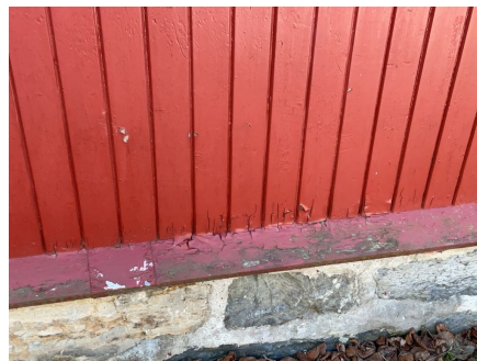
Råteskade nederst på kledning.
