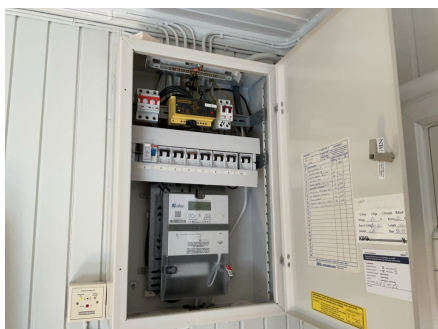
Sikringsskap plassert i loftsetasje.
