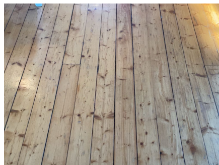
Slitasje på overflater enkelte steder.
