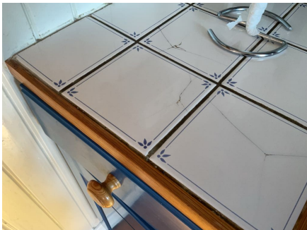
Sprekker i fliser ved komfyr.
