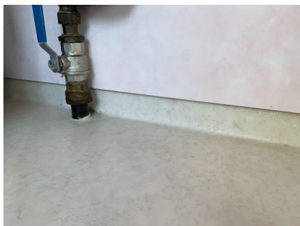
Lav "oppkant" på tetting rundt rørføring.
