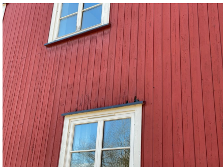
Råteskade registrert over vindu.
