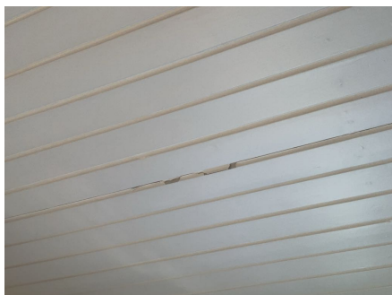
Sprekker i maling enkelte steder.
