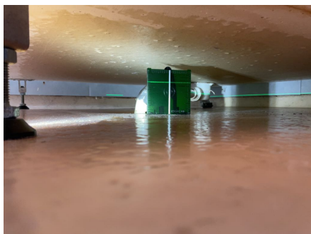
Svakt fall til sluk, men ikke motfall.
