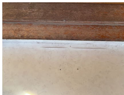
Sprekk i membran
