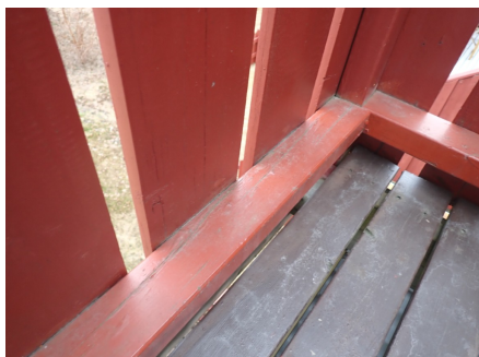
Noe slitasje i rekkverket.
