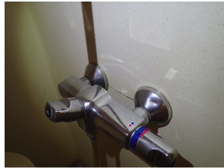
Sprekk i tettesjikt mellom rør til dusjbatteri.
