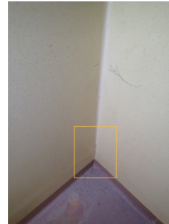
Liten sprekk nederst i hjørnet på vegg.
