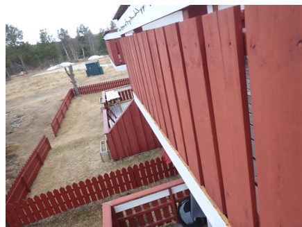
Noe slitasje i rekkverket.
