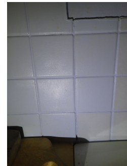
Riss i fuger bak komfyr. En kan også se noe manglende fugemasse.
