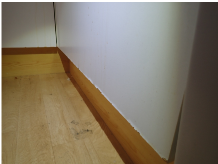
Fuktskader i fronter.
