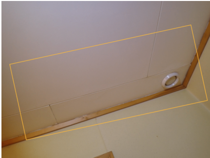
Påvist skader i himlingsplater innenfor markert område.
