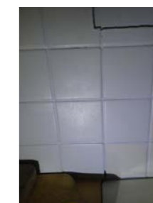
Riss i fuger bak komfyr. En kan også se noe manglende fugemasse.
