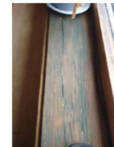
Sprekker i utføring i stuevindu.
