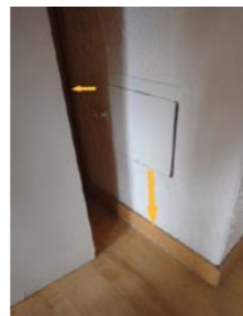
Sotluke. Mindre enn 300 mm mot brennbare materialer. Ingen plate på gulv.
