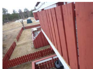
Noe slitasje i rekkverket.
