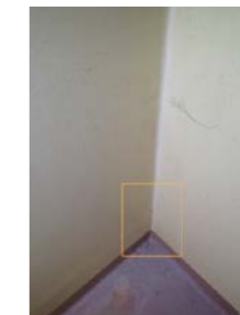
Liten sprekk nederst i hjørnet på vegg.
