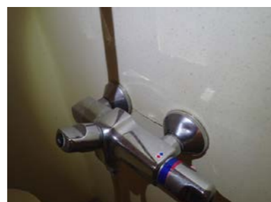
Sprekk i tettesjikt mellom rør til dusjbatteri.
