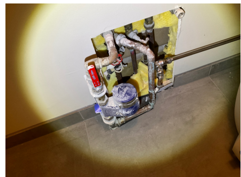
Inntak og stoppekran i bod
