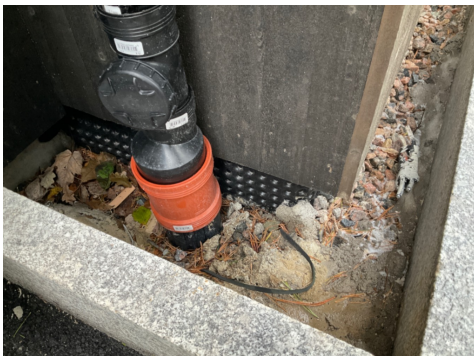
Taknedløp ledes til overvannsrør
