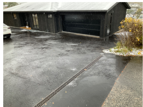
Avrenning i topp av gårdsplass og foran garasje
