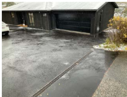
Avrenning i topp av gårdsplass og foran garasje
