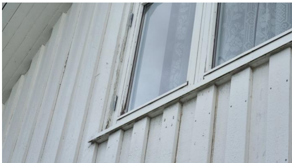
Enkelte vinduer er noe utvendig værslitt.
