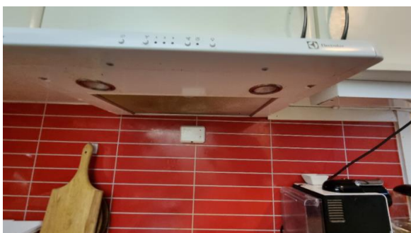
Det er kjøkkenventilator med avtrekk ut.
