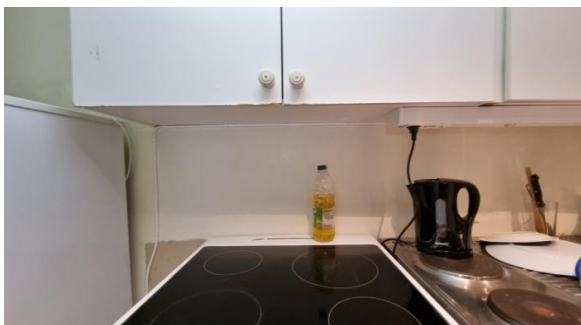
Det er manglende forsert mekanisk avtrekk fra kokesone i kjøkkenet.
