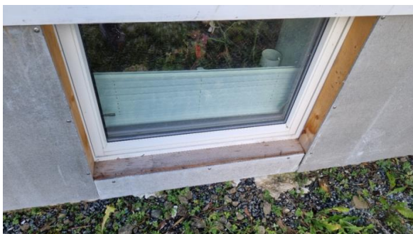
Det mangler beslag i overgang mellom vinduer og grunnmurplater.
