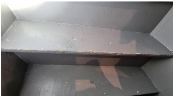
Trapp har noe slitasje.
