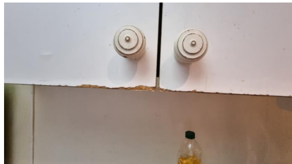
Innredningen har slitasjer.
