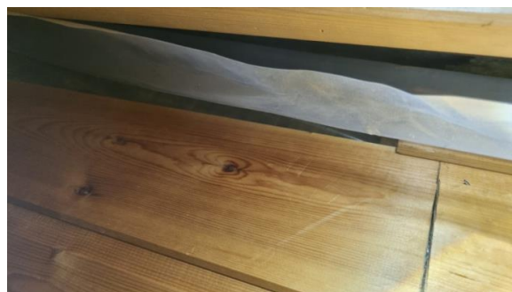
Det ble registrert utettheter i dampsperre i overgang mellom tak og knevegg.
