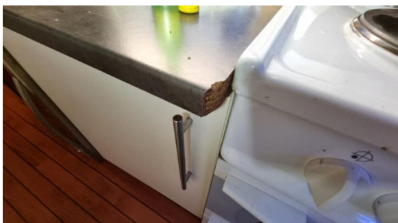
Det mangler kantbånd på benkeplate.
