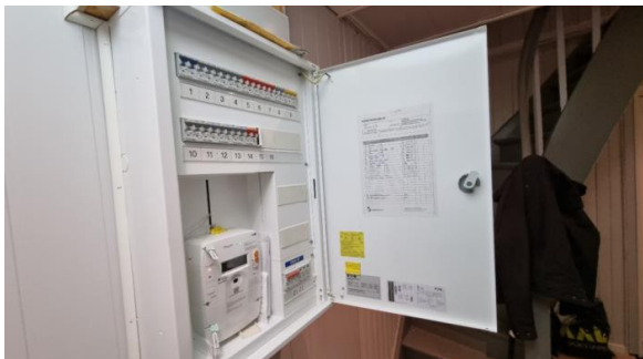
El-skap i 2. etasje.
