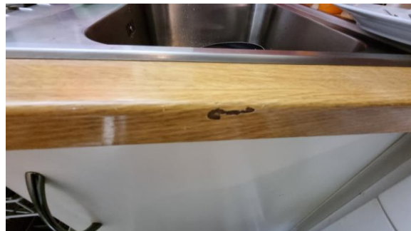
Sår/hakk i benkeplate.
