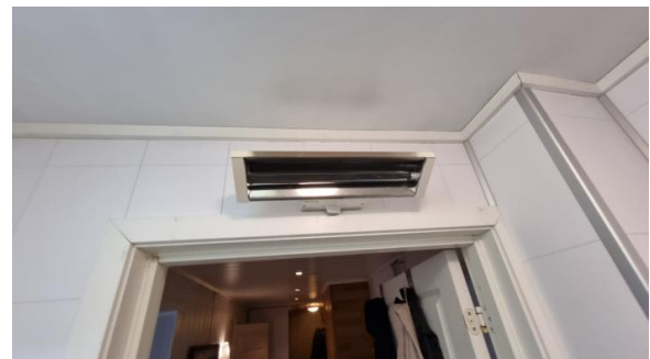
Badet blir oppvarmet med stråleovn montert på vegg.
