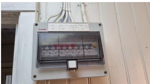
El-tavle i 1. etasje.
