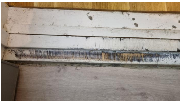
Dør subber i terskel.
