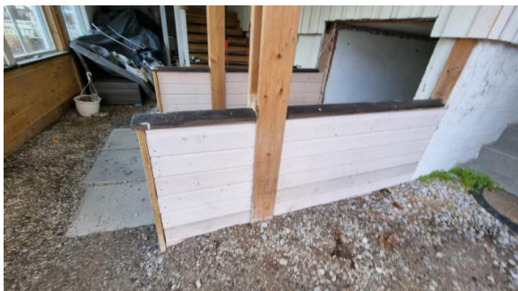
Rekkverk/vegger er lavere enn 90 cm.
