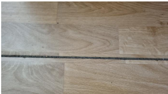
Sprekk i skjøt i laminatgulv.
