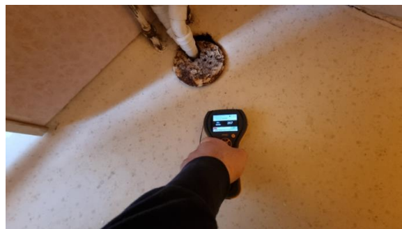
Det ble fuktmålt ved befaring, svakt forhøyet fuktverdi ble registrert.
