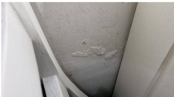
Det er saltutslag i grunnmur.
