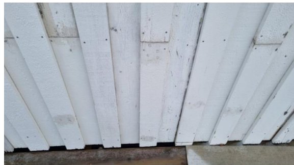
Det er værslitt/opsprukket trevirke/trepaneler.
