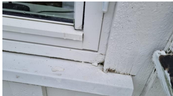
Utvendig omramminger på vinduer er montert helt ned til vannbordet, dette kan føre til vannoppsug/råte i omramming/dekkbord. Det er anbefalt med minimum 6 mm avstand fra nedkant av omramming til det nederste vannbrettet.
