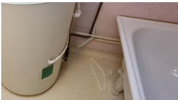
Eldre vannledninger av kobber på bad i loftetasjen.
