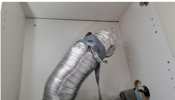
Det er utettheter i avtrekksrør for ventilator.
