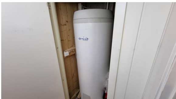
Varmtvannsbereder av merket oso på 287 liter og 3000 watt fra 2013, plassert i kott i kjelleretasjen.
