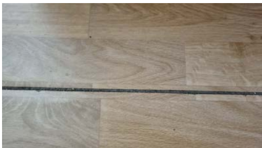
Sprekk i skjøt i laminatgulv.
