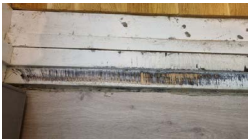
Dør subber i terskel.
