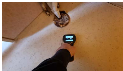
Det ble fuktmålt ved befarings, svakt forhøyet fuktverdi ble registrert.
