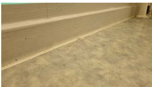
Det bemerkes at tettesjikt (belegg) ikke har oppkant på vegg.
