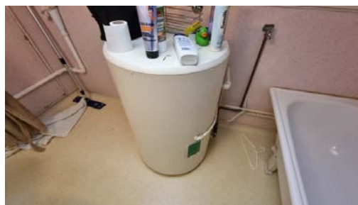
Varmtvannsbereder av eldre dato på bad i loftetasjen.
