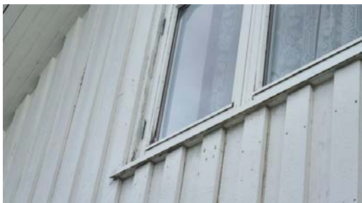
Enkelte vinduer er noe utvendig værslitt.
