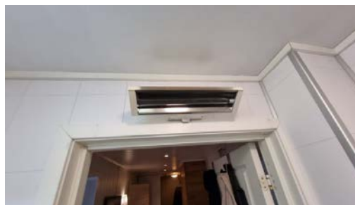
Badet blir oppvarmet med stråleovn montert på vegg.
