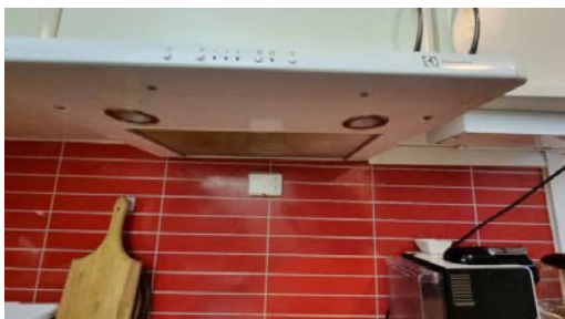
Det er kjøkkenventilator med avtrekk ut.
