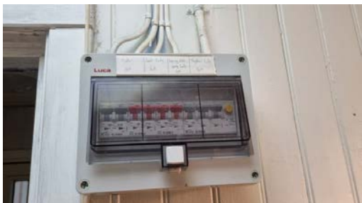
El-tavle i 1. etasje.
