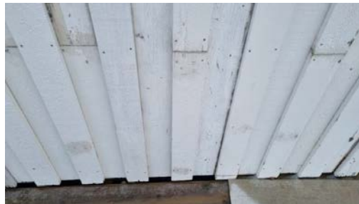
Det er værslitt/oppsprukket trevirke/trepaneler.
