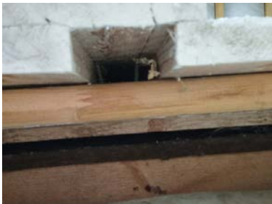
Det er ingen musesperre i nedre kant av konstruksjon.
