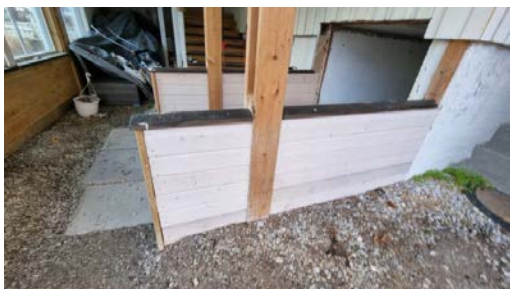
Rekkverk/vegger er lavere enn 90 cm.
