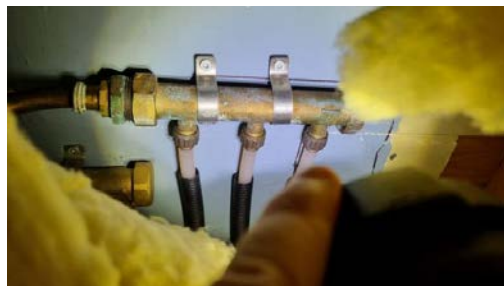
Det er påvist at eventuelt lekkasjevann fra rør i rør system ikke ledes til sluk eller annen kompenserende løsning, samt at det mangler tettemuffer i enden av varerør på rør-i-rør-system.
