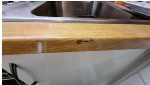
Sår/hakk i benkeplate.
