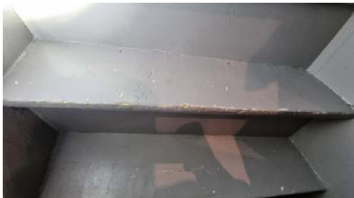
Trapp har noe slitasje.
