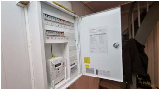
El-skap i 2. etasje.
