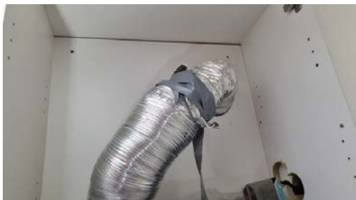
Det er utettheter i avtrekksrør for ventilator.
