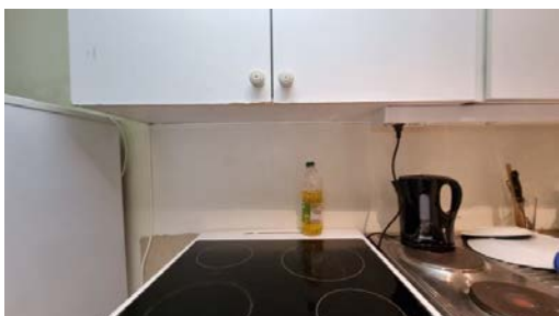
Det er manglende forsert mekanisk avtrekk fra kokesone i kjøkkenet.
