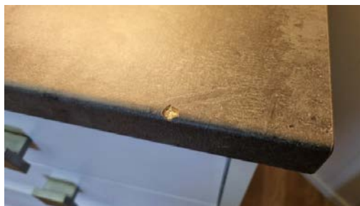
Sår/hakk i benkeplate.
