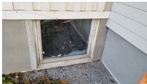
Vindu er værslitt. Det bemerkes at vinduet ligger lavt i forhold til terrenget ved grunnmur.
