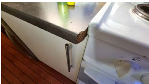
Det mangler kantbånd på benkeplate.
