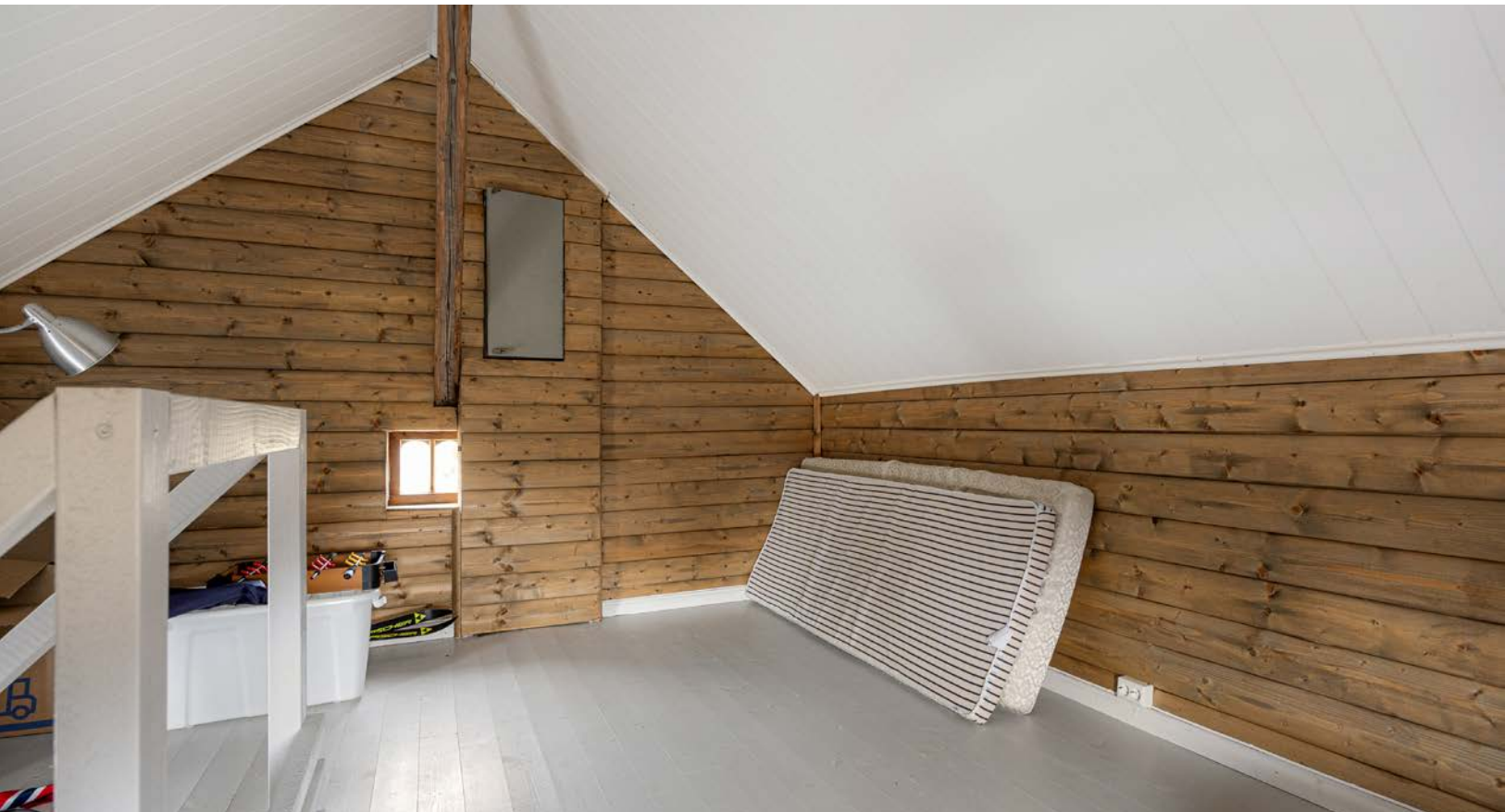
Det foreligger ikke bruksendring for disse rommene, og rommene kan derfor ikke lovlig brukes som oppholdsrom.
