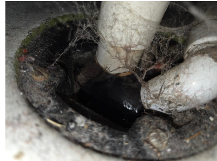
Eldre plastsluk (Begrenset inspeksjon pga dusjkabinett)
